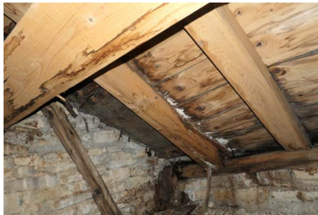
Photographie en sous-face d'une volige non ventilée sous un écran pare-pluie
