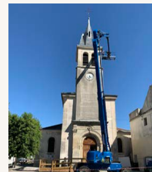
Pour les édifices non MH: Accès internet haut débit pour tous (antenne 4G sur le clocher) (derrière les abat-sons,...)
